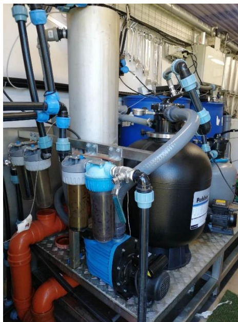
Figur 4. Förbehandling med grovfilter, förfilter och filtrattankar
